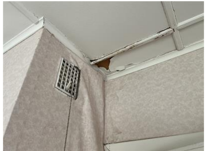
Fuktfläckar i taket i sovrums2.
