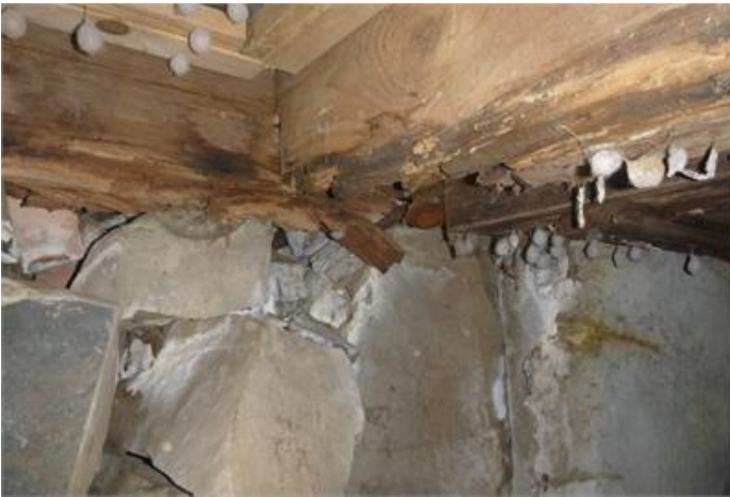
Torpargrund, rötskador i syllar och bärlinor.
