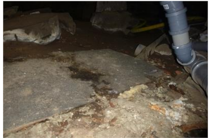
Torpargrund, rötskadat material och mikrobiell påväxt på markytan.
