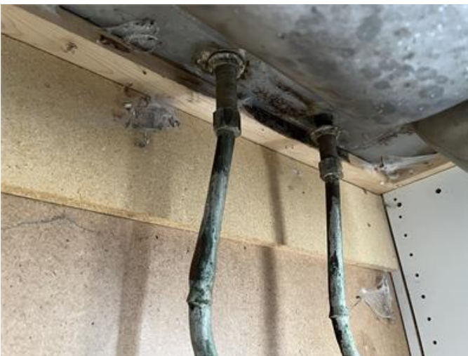
Kök, äldre vatteninstallationer med rost/ärgningar.
