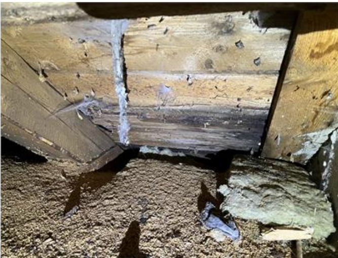
Tak, rötskador i underlagstaket runt murstocken.
